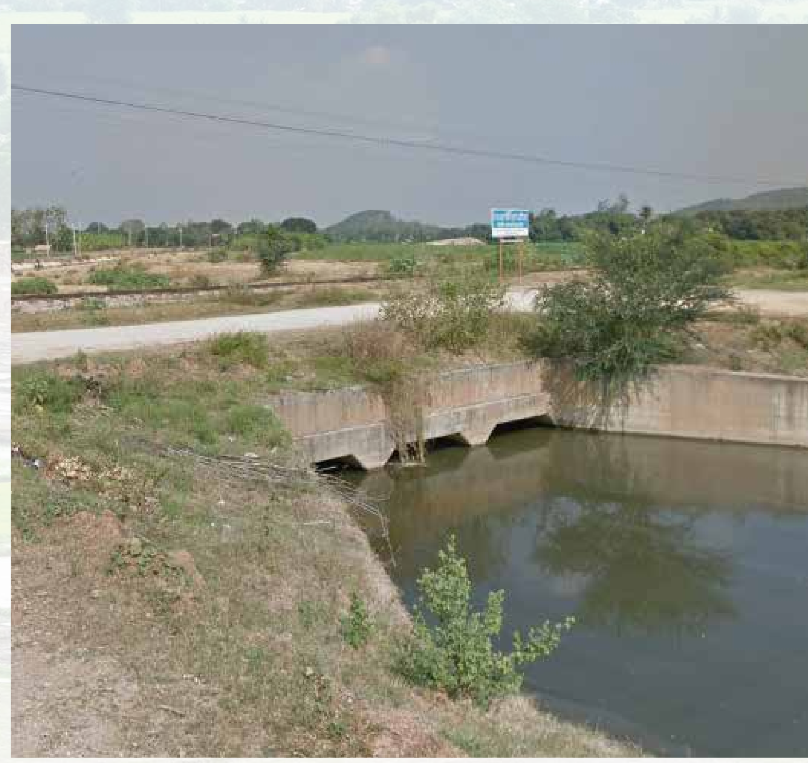
ท่อลอดถนน
